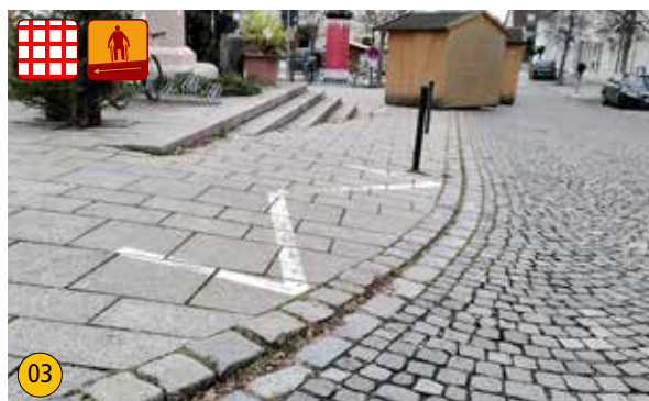
Gefälle in mehrere Richtungen auch auf Platzseite, unebenes Bord, unebenes Kopfsteinpflaster, Übergang in der Schrägen
