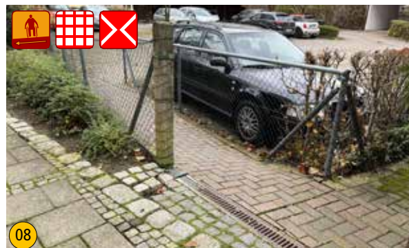
08 mangelnde Sicherheit durch Quergefälle und starke Unebenheiten, unzureichende Breite für Rollstühle, fehlender zweiter Handlauf etc.
