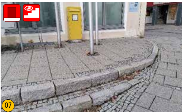
Der Zugang zum Rathaus wird durch Einbauten und Fahnenmasten verstellt; die Stufen heben sich optisch kaum von der Umgebung ab
