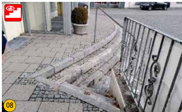
Stolperrisiko auch durch unübersichtliche Stufen zum benachbarten Rathausgebäude. Situation wird in der Neuplanung (Stand 01.03.2023AB ARCHITEKT.UR) entschärft
