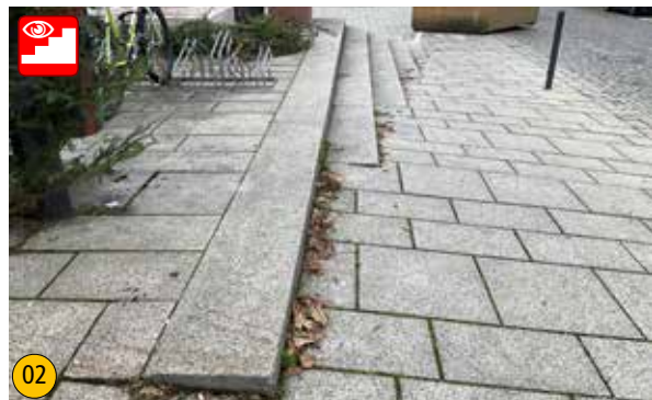
02 Stolpergefahr durch Stufenanlagen mit verschleppenden Stufen ohne Markierungen und Absicherungen
