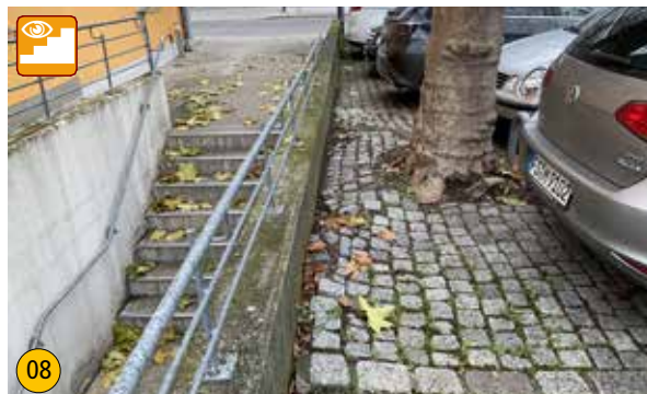
Die hier vorhandene Treppe ist bedingt barrierefrei. Ein zweites Geländer fehlt.
